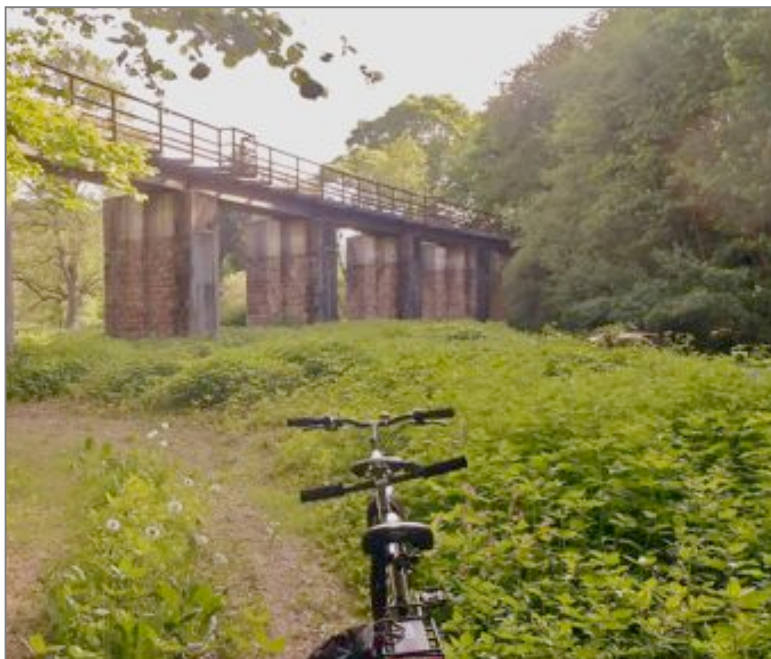
Abbildung 130: Blick auf die nicht mehr befahrbare Theelbrücke der ehemaligen Bahnstrecke Dillingen und Lebach
