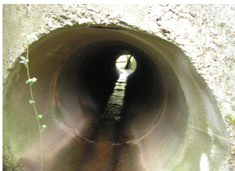
Abb. 5.8: Typische Situation an vorhandenen Wegedurchlässen. Oben: Auskolkungen mit Sohl sprung an der Dammunterseite. Unten: Blanke Betonsohle. Darstellung: KRH 1 u. 2, UG Obere Blies.
