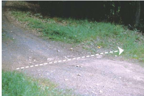
Abb. 6.2: Beispiel für wegebauliche Maßnahme: wasserableitende Mulde mit Entwässerung in die angrenzenden Waldbestände. Quelle: SCHÜLER (2005)
