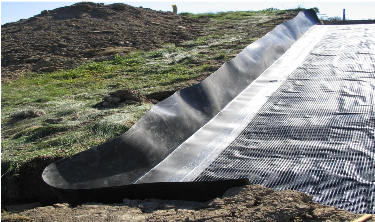
Bild 14: Folie am Rand des Testfeldes zur Verhinderung des Eintritts von Fremdwasser aus der Umgebung
