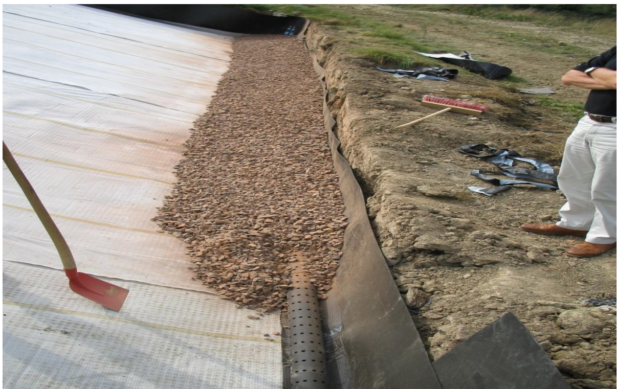
Bild 10: Rohr zur Ableitung des Drainagewassers am Tiefstpunkt des Testfeldes
