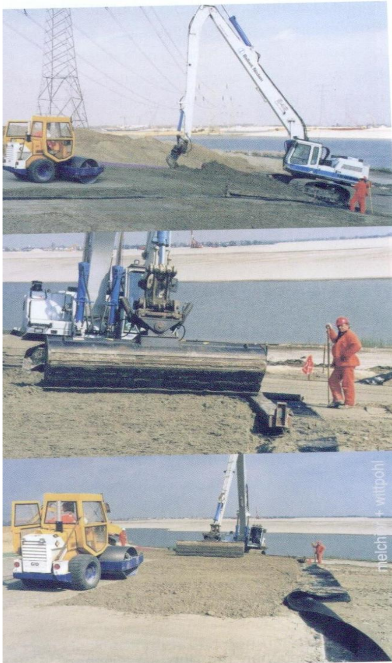
Bild 9-1: Klassischer Einbau von Trisoplast mit Langarmbagger und Walze (aus Melchior 2005b, S.129)
