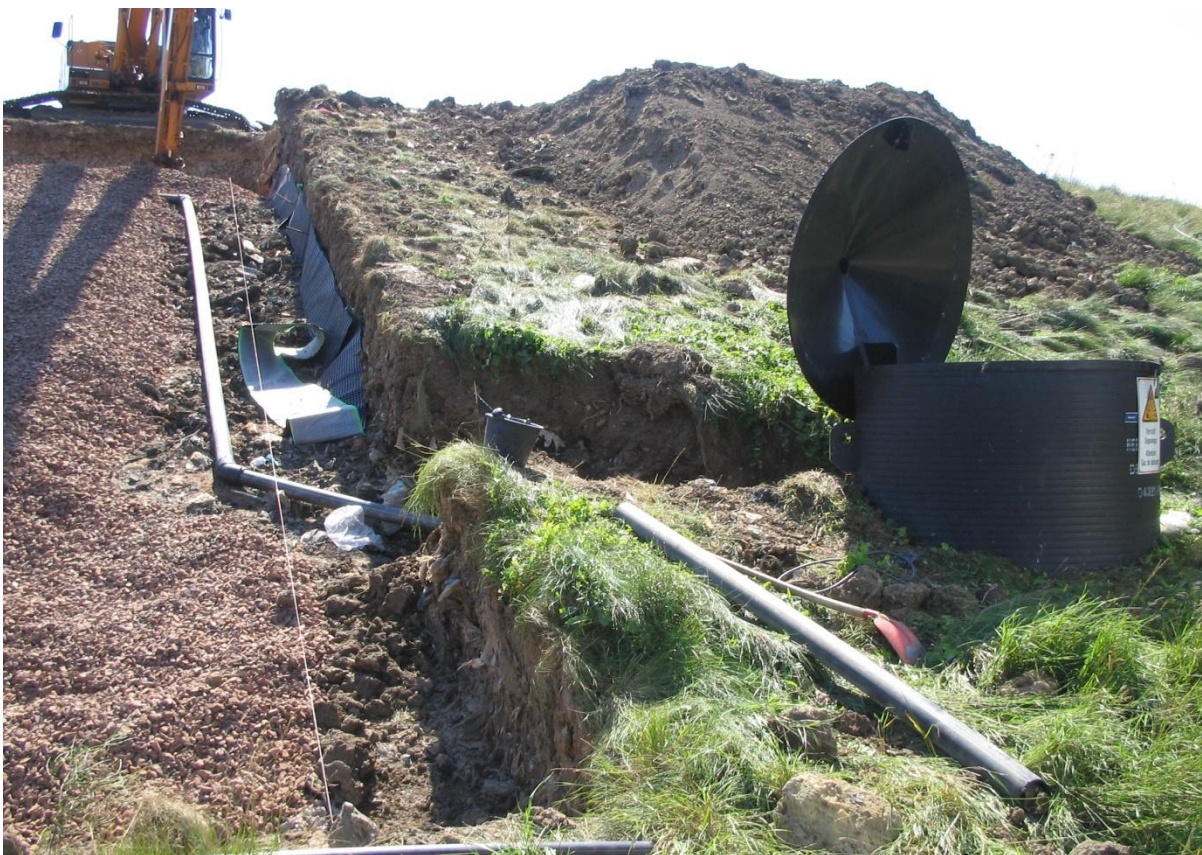
Bild 6: Anschluss des Rohres an Gasbrunnen 2
