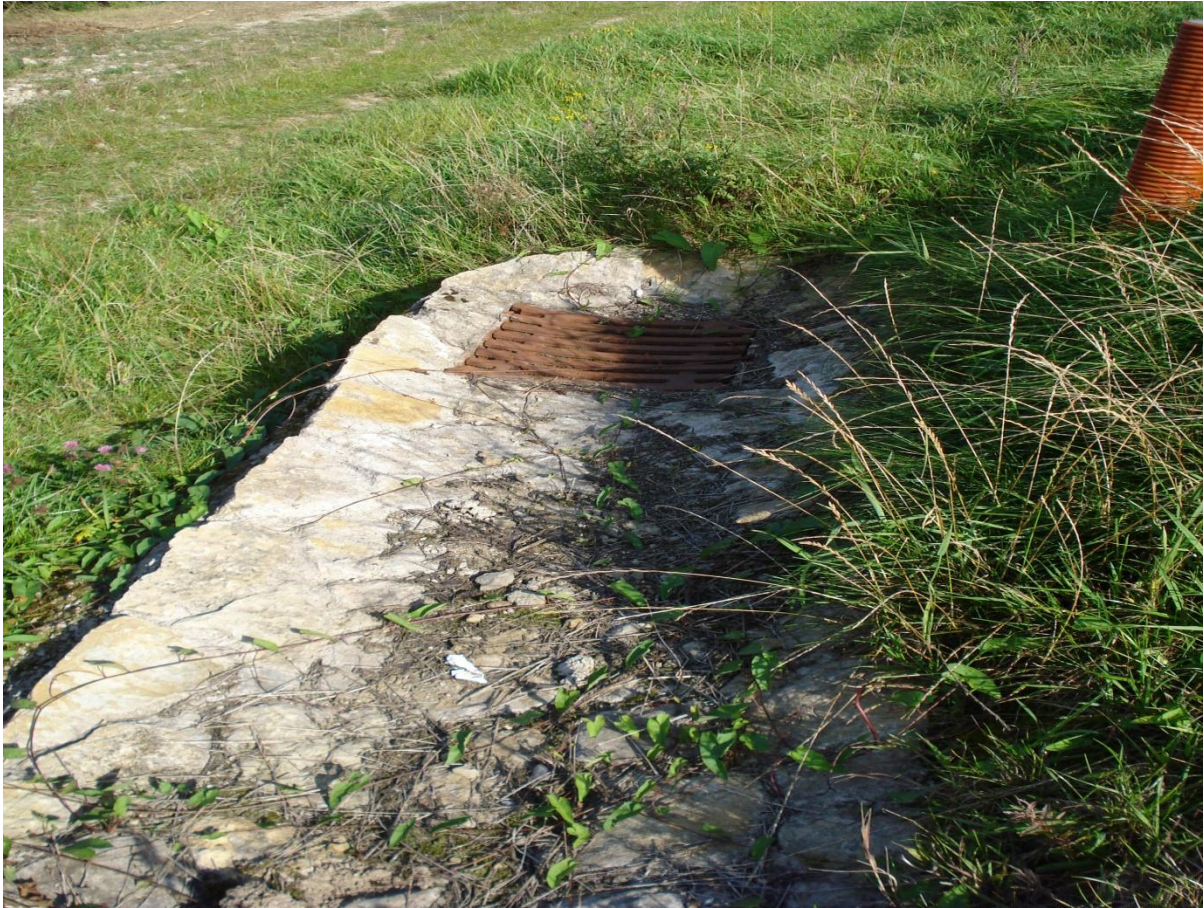
Bild 13: Einlaufschacht zum Auffangen des Oberflächenwassers
