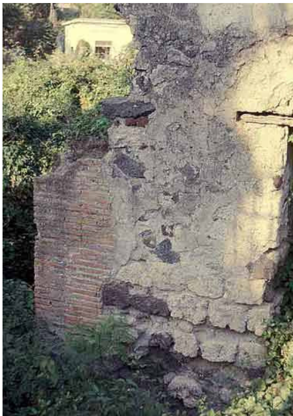
Abb. 31 - Erdbebenschaden. Links die in Ziegelmauerwerk ausgebesserte Fensterlaibung von Raum 5,2bis.
