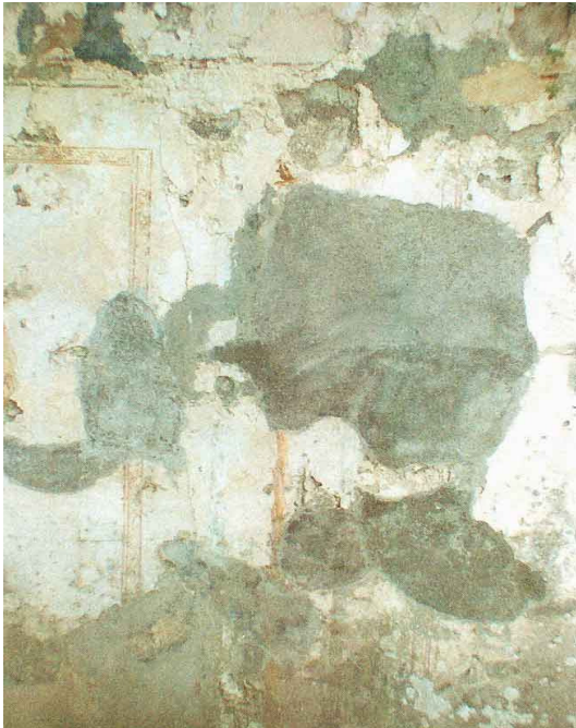
Abb. 130 - Reste der weißgrundigen Wanddekoration in Korridor 5a. Erstes Feld und erster Kandelaber von Osten.
