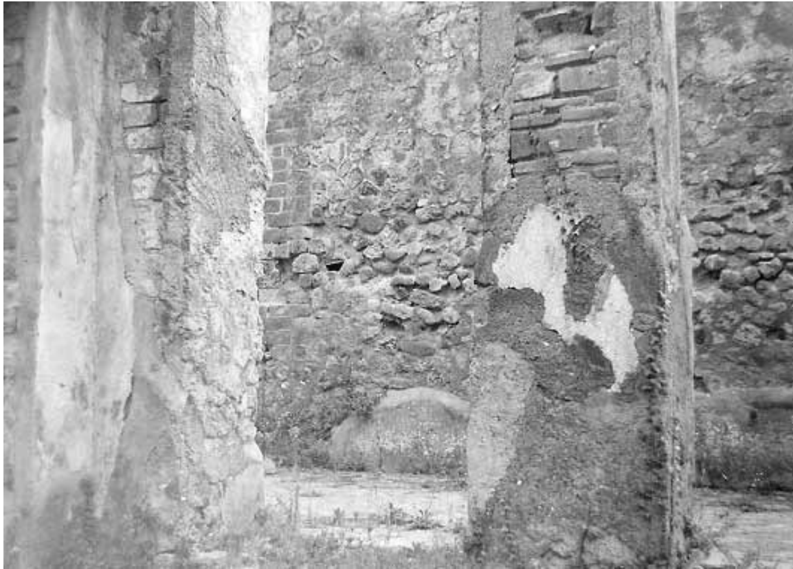
Abb. 143 - Portikus 5c. Südlicher Eckpilaster (li.) mit seitlicher Verstärkung, die im unteren Bereich antiken Putz trägt.
