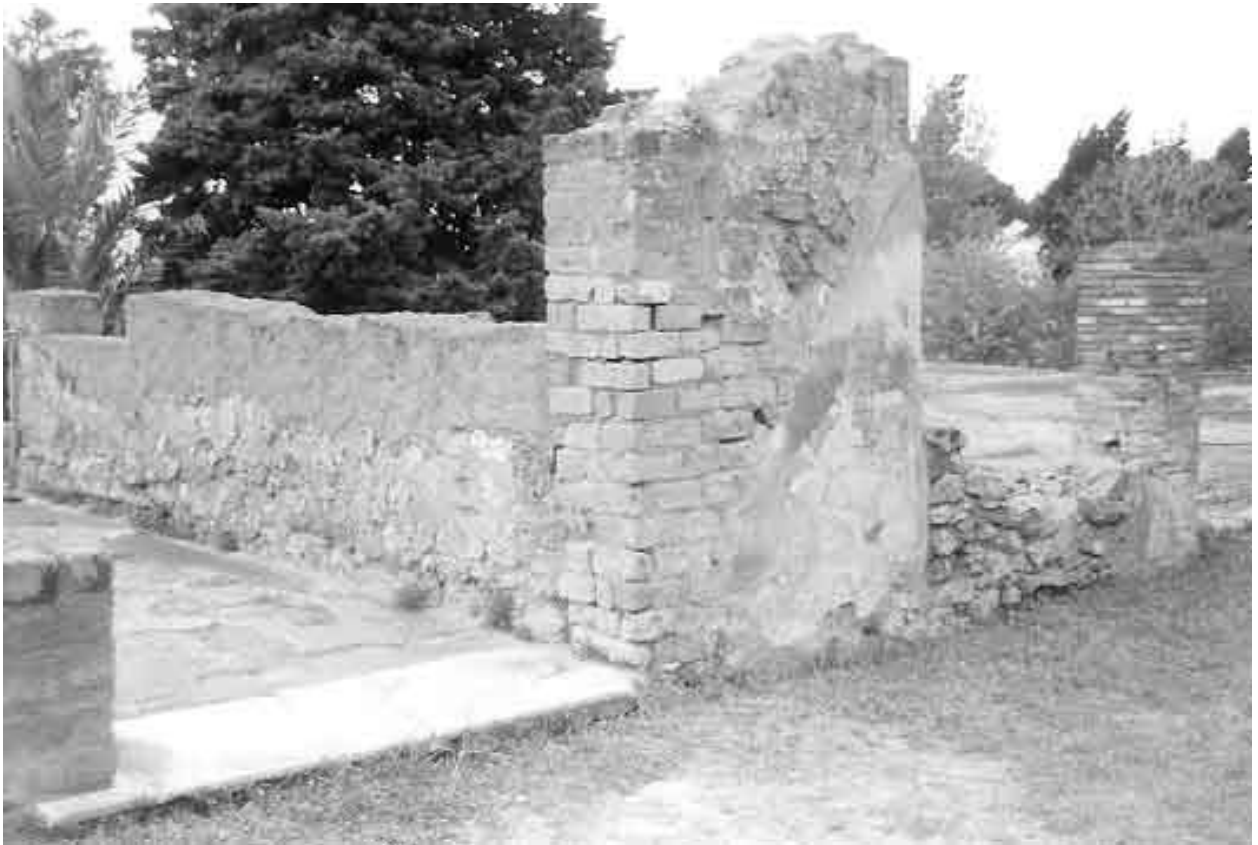
Abb. 123 - Saal 4,9. Nordostecke mit Zugangstür. Rechts daneben eine vermauerte Säulen der ursprünglichen Bauphase von Loggia 4 mit nachträglich angesetztem grobem Mauerwerk einer Fensterbrüstung.
