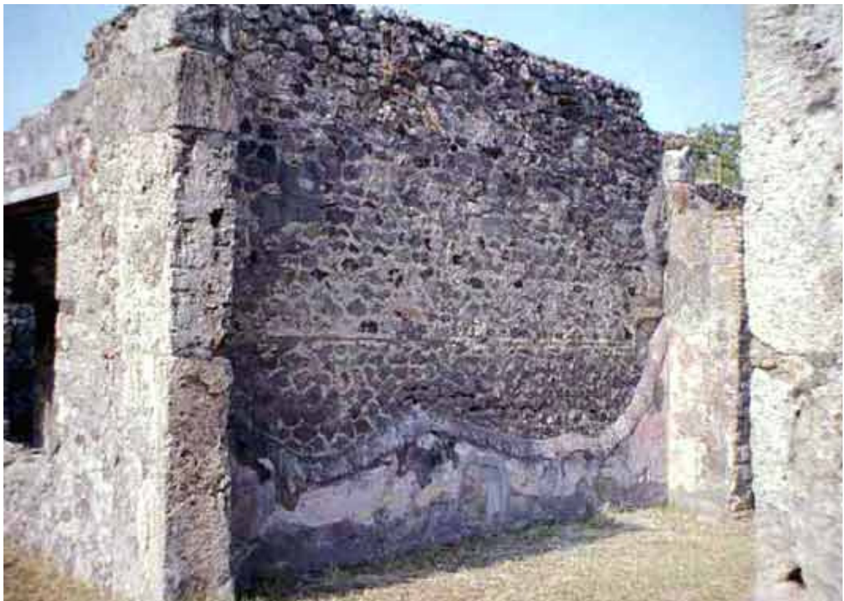
Abb. 108 - Tablinum 4,2. Nordwand mit heutigem Erhaltungszustand des Wandputzes.
