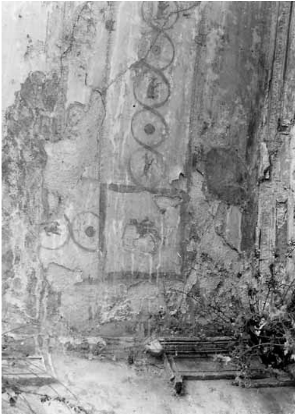
Abb. 169 - Raum 5,5. Nordostecke mit Resten des aufwendigen Stuckgesims der Nordwand und Rest der Gewölbekoration.
