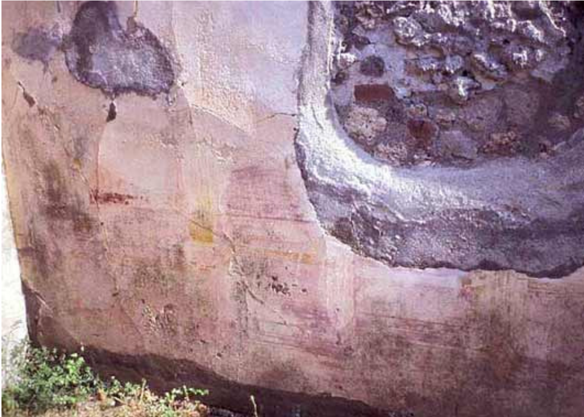
Abb. 117 - Raum 4,3. Südostecke mit Resten der Dekoration II. Stils auf der Südwand. Deutlich erkennbar der mehrfach zurückspringende Sockel und die kanellierten gelben Säulen darauf.
