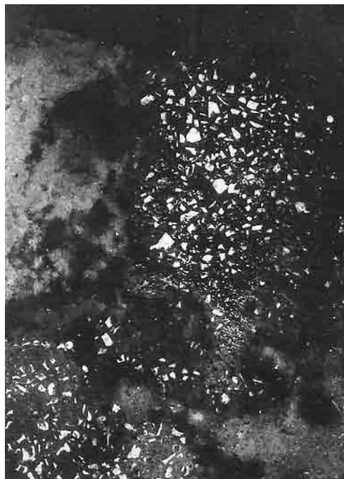
Abb. 222 - Raum 5,8-5,10. Bodenbelag aus einem schwarzen Estrich aus zerstörter Lava mit weißem Travertinsplitt.
