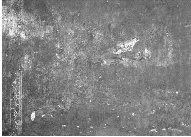
Abb. 198 - Raum 5,8. Ostwand. Mittelvignette des linken Wandfeldes. Von der ehemaligen hohen Qualität der heute stark beschädigten Malerei zeugt der realistisch wiedergegebene Schatten auf der Standfläche der Darstellung.
