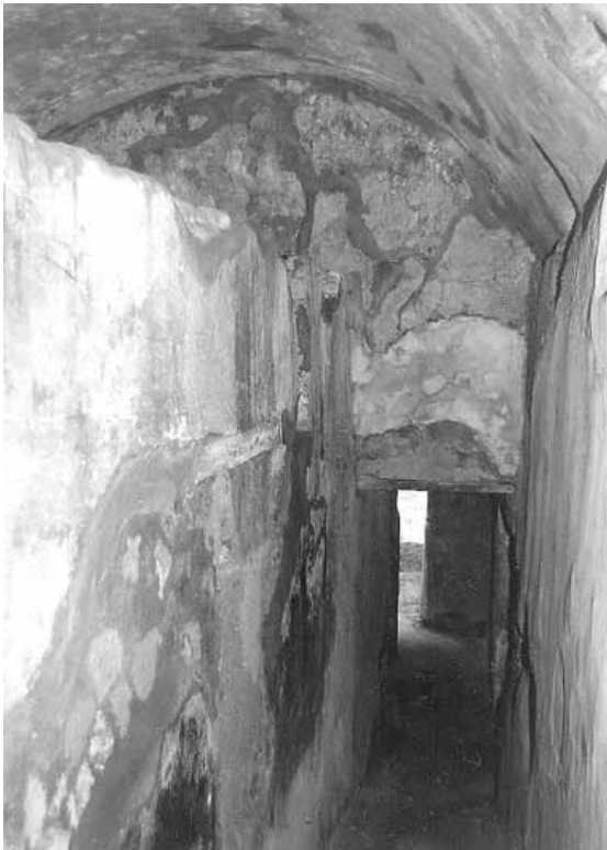
Abb. 242 - Blick von Osten in den zum Garten hin abfallenden Korridor 5,12. Die Tür im Mittelgrund markiert die Ostwand des nachträglich eingebauten Raum 5,13.
