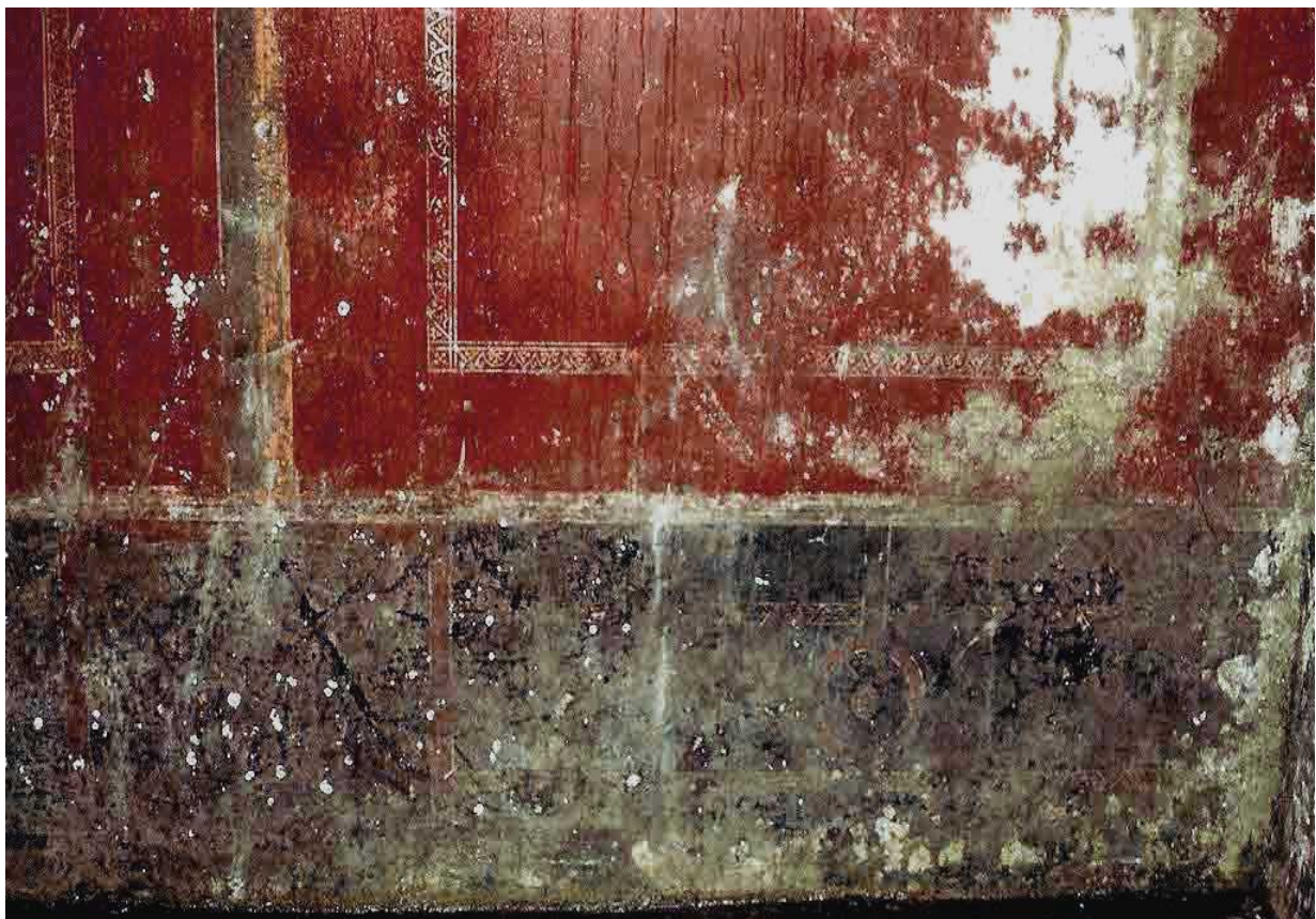
Abb. 233 - Raum 5,10. Nordwand. Stark beschädigte Sockelzone unter dem rechten Wandfeld.
