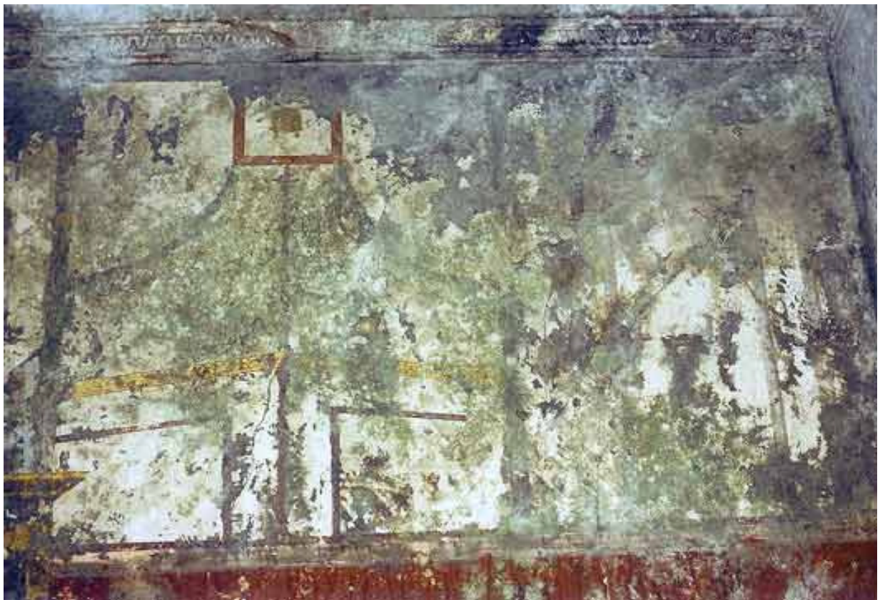
Abb. 228 - Raum 5,10. Nordwand. Reste der Dekoration der Wandoberzone über dem rechten Wandpaneel. Links ein von einem Maskaron bekrönter Pflanzenkandelaber. Rechts in der Raumecke erkennt man die gleichen Phantasiearchitekturen wie in den Ecken der Ostwand.
