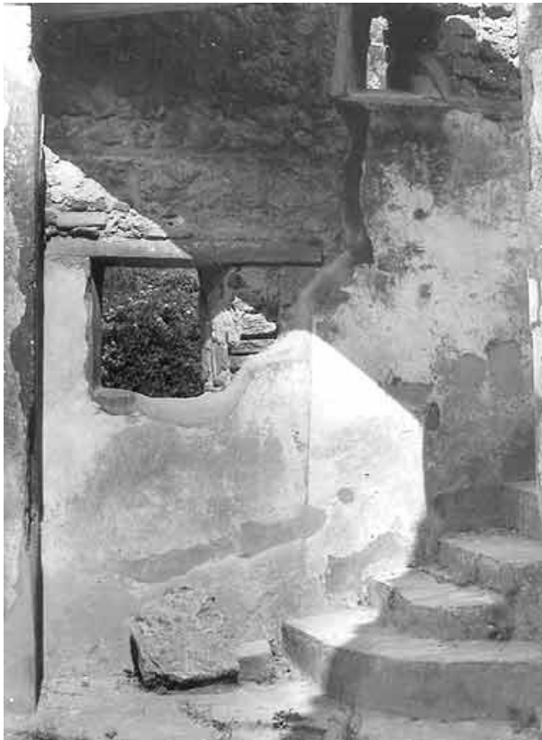
Abb. 269 - Raum 5,18. Ostwand des Zugangsraums zum Gartengeschoss mit vermauertem ehemaligen Nebeneingang und Treppe zum Hauptgeschoss.
