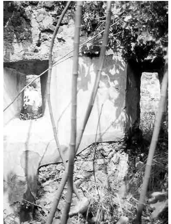
Abb. 282 - Raum 7,5. Fenster in der Ostwand, die unmittelbar oberhalb des Bürgersteigs der Gräberstraße vor der Villenfassade liegen.
