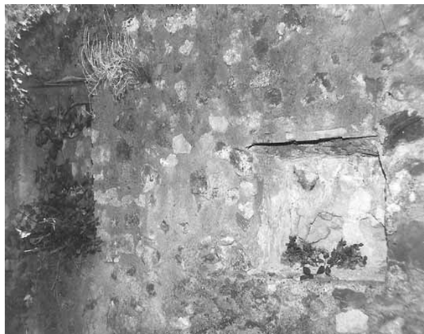
Abb. 289 - Blick auf die Südwand von Raum 7,6b und 7,6c. Links das in eine Wandnische umgewandelte ehemalige Fenster zum Gang 6b. In der Nische von Raum 7,6c (re.) Reste des antiken Weißputzes.
