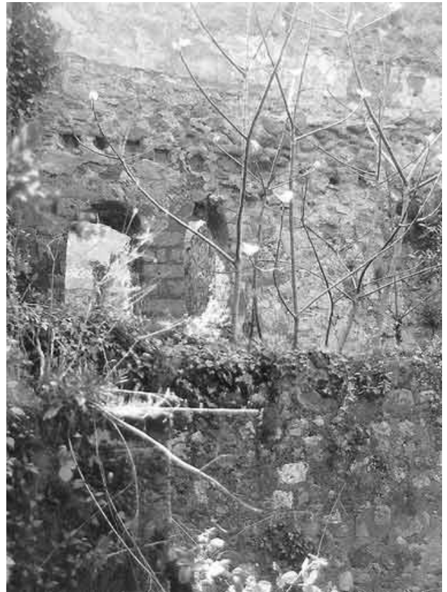
Abb. 280 - Gang 6b. Doppelfenster in der Südwand, durch das der Korridor 5,12 und der Vorratsraum 5,16 ihr Licht bekamen. Darüber die Balkenlöcher der ursprünglichen Überdachung von Gang 6b.
