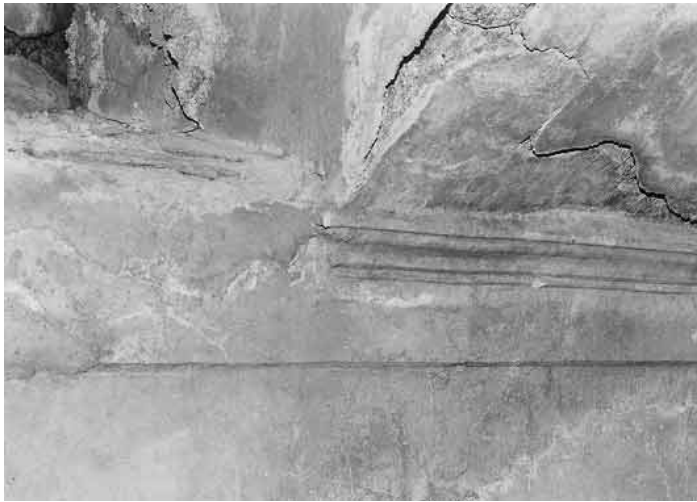
Abb. 275 - Keller 6. Westflügel. Modern vermauertes Schlitzfenster (li.) und gegen das ältere Stuckgesims stoßende zweite Putzschicht des Kellergewölbes im nördlichen Teil des Westflügels (re.).
