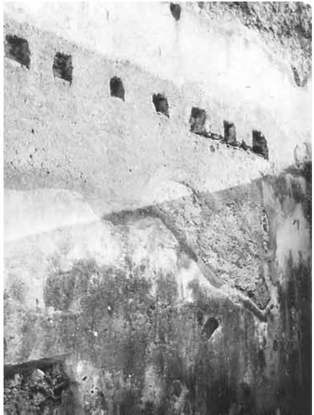
Abb. 270 - Raum 5,18. Südwand mit Balkenlöchern für den späteren Obergeschossraum. Unmittelbar darunter der Holzsturz des vermauerten und in einen Wandschrank umgewandelten ehemaligen Zugangs zum Obergeschoss.
