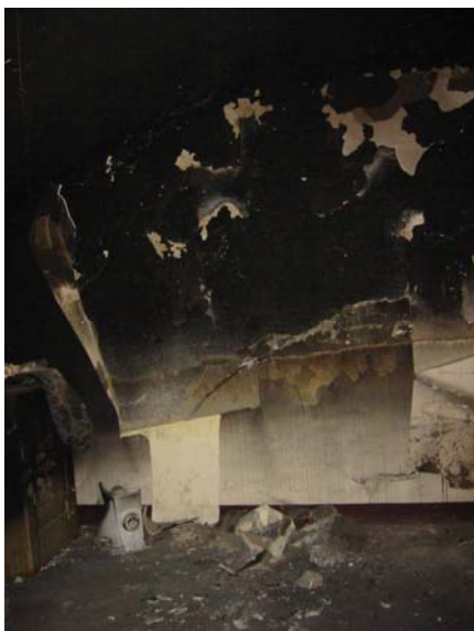
Foto 333: Durch Übungen der Feuerwehr verschandelter Kasernenbereich im Fort Plappeville
