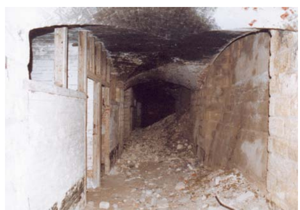
Foto 168: Eingestürzte Mauern im Innern der Kaserne des Fort La Chaume
