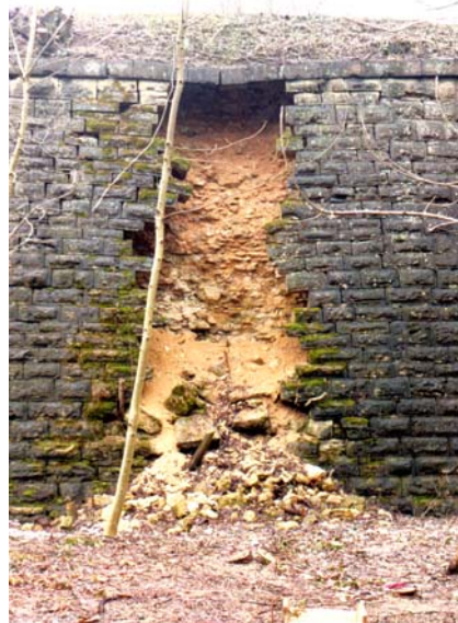
Foto 349: Schäden an der Mauer der Festungsstadt Longwy (Meurthe et Moselle)
