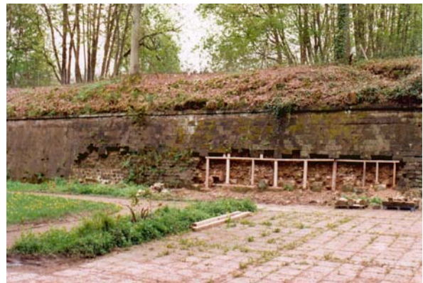
Foto 348: Notdürftig gestützte Mauer des Hornwerks in Saarlouis vor der Restaurierung
