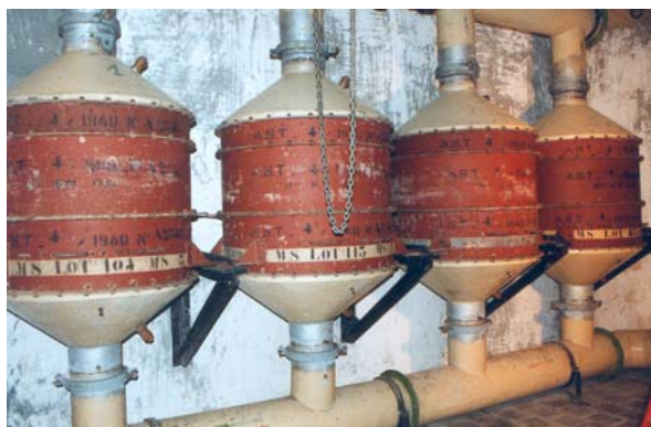
Foto 43: Filteranlage (Abri Cattenomer Wald, Lothringen)
