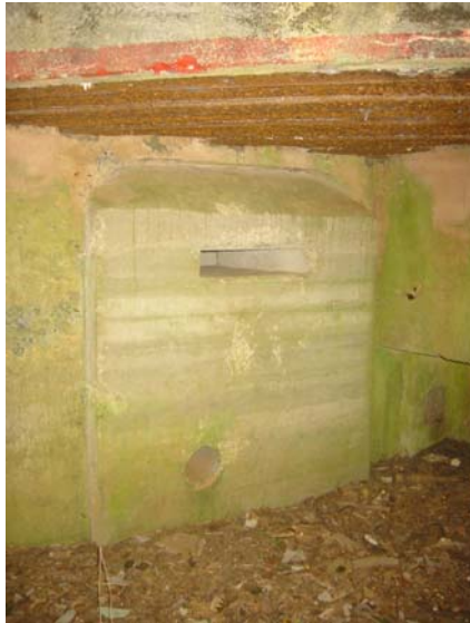
Foto 341: Zugemauerter Eingang eines Bunkers bei Besseringen mit einem runden Zugang in Bodennähe für Kleintiere und einem Einflugschlitz für Fledermäuse
